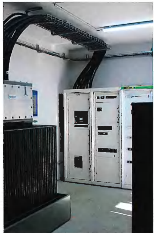
Transformateur et TGBT Pierrafort
